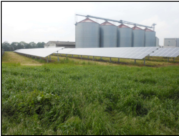
Abb. 6: Beispiel einer Photovoltaikanlage mit feststehenden Paneelen
